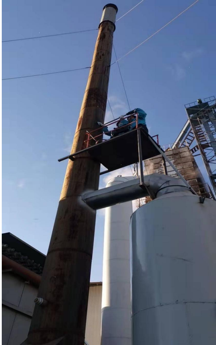
热风炉排气筒出口
